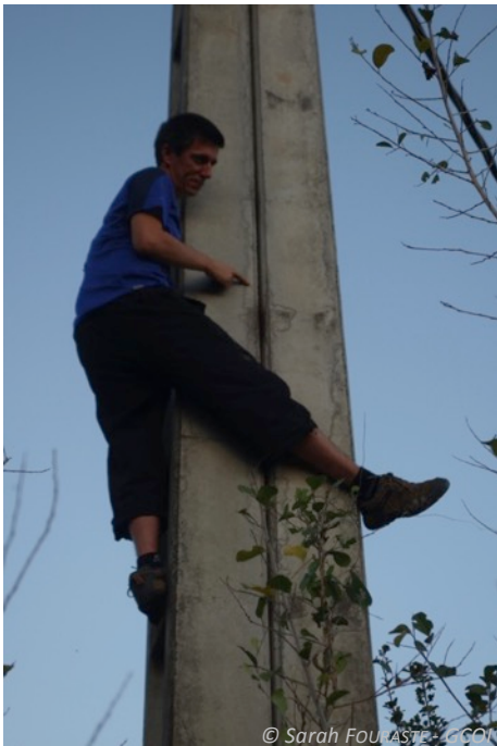
© Sarah FOURASTE - GCOI Entrée du gîte à Chaerephon spp entre les poteaux béton
