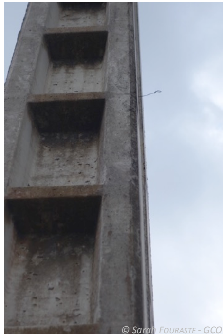
© Sarah FOURASTE - GCOI Dispositif de fixation du data-logger visible de l'extérieur du poteau. Pour éviter les curieux et le vandalisme, le dispositif est complètement inséré dans la fissure de manière à ne pas être visible de l'extérieur.
